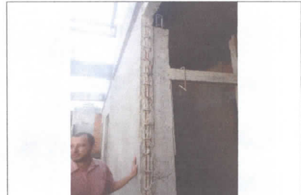
20. Cortes en concreto y acero expuesto en elemento construido recientemente, además de no manejar los nudos con los estribos
