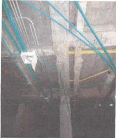
37. Vigas sin continuidad y con acero expuesto
