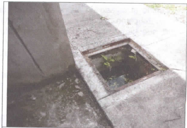
32. Vegetación y agua estancada en las cajas de inspección
