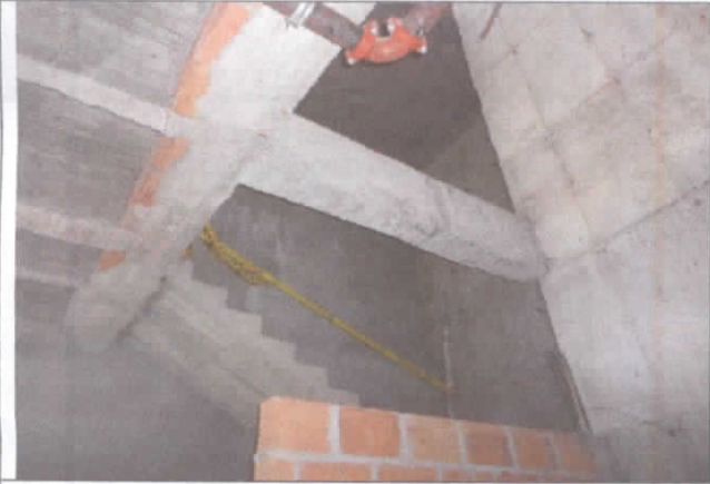
16. Elementos no estructurales, en sitios de elementos estructurales. Y viga totalmente suelta sin continuidad y empotramiento
