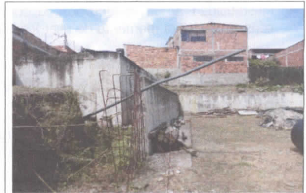
36. Muro innecesario. Acero expuesto
