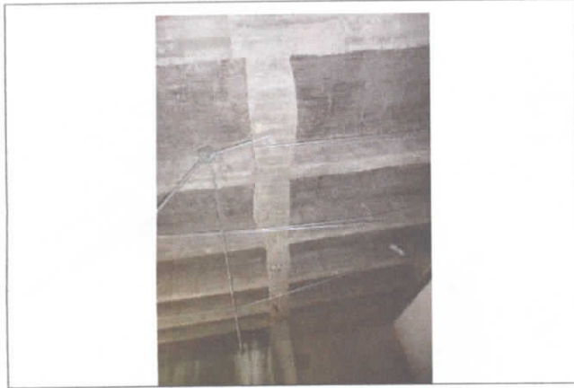
25. Ejemplo de falta de continuidad de la sección de viguetas y riostras
