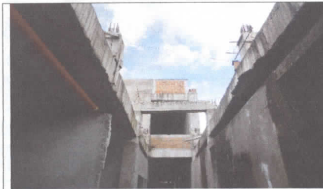
19. Viga desnivelada o que no obedece a la disposición ortogonal
