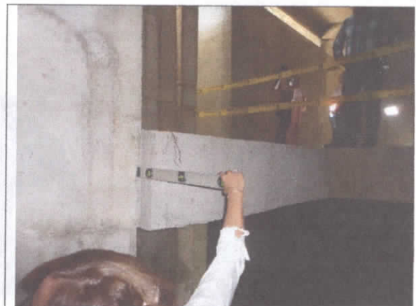
24. La misma viga de la imagen 23. Extremo sin continuidad o empotramiento. Elemento totalmente suelto
