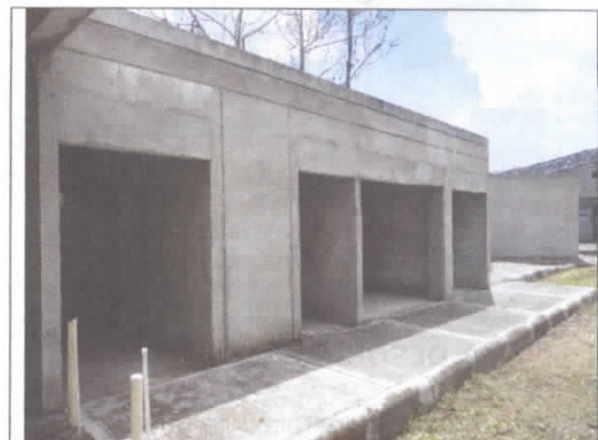
13. Dinteles contruidos sin un adecuado proceso Constructivo, sin apoyo o empotramiento
