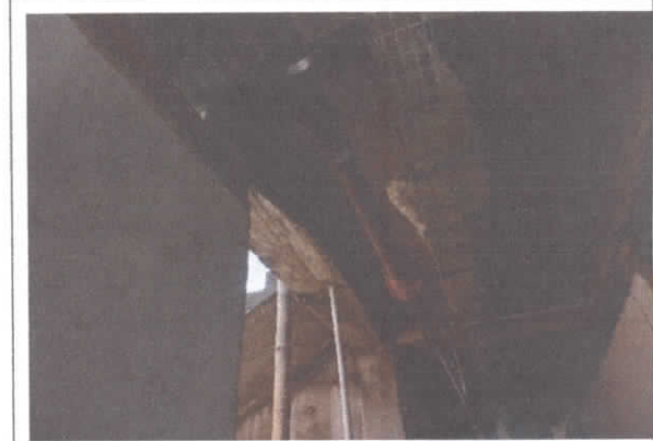
26. Vigas sin dimensión definida, generando pesos muertos a la estructura
