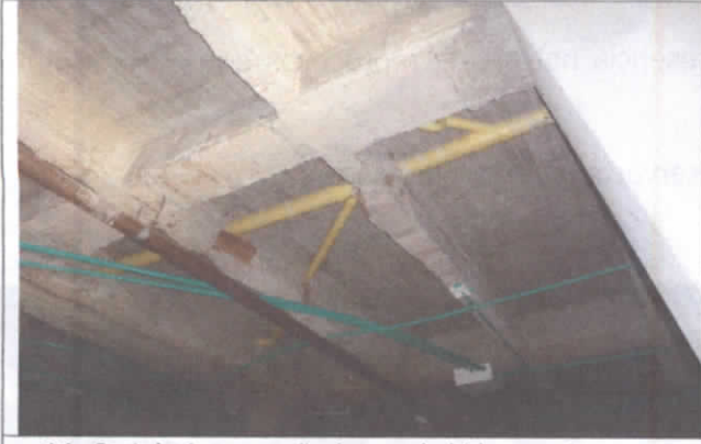
14. Instalaciones sanitarias, embebidas en vigas y viguetas a través de demolición de las mismas de manera contraproducente
