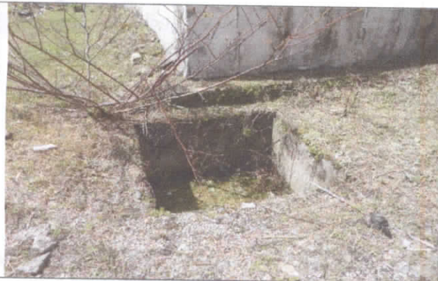
31. Cajas totalmente obstruidas
