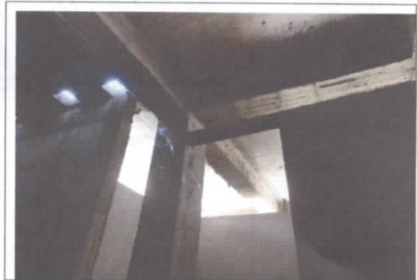
11. Elementos demasiado esbeltos que no cuentan con ninguna utilidad, por el contrario generan riesgo
