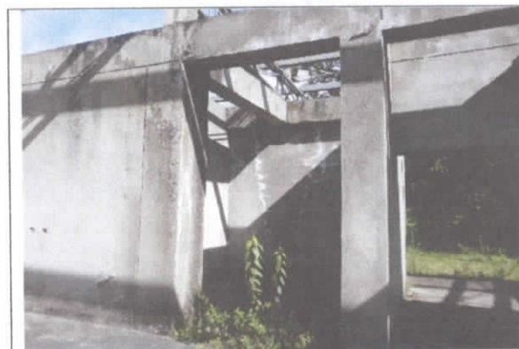
2. Eflorescencia en mampostería a la intemperie
