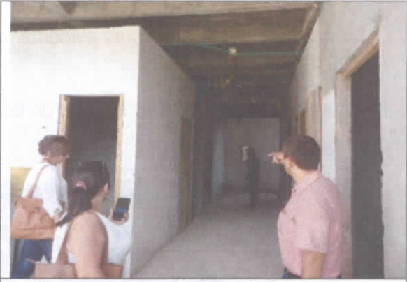
15. Manejo aceptable de instalaciones, por debajo de vigas y viguetas en otro sector de la Obra
