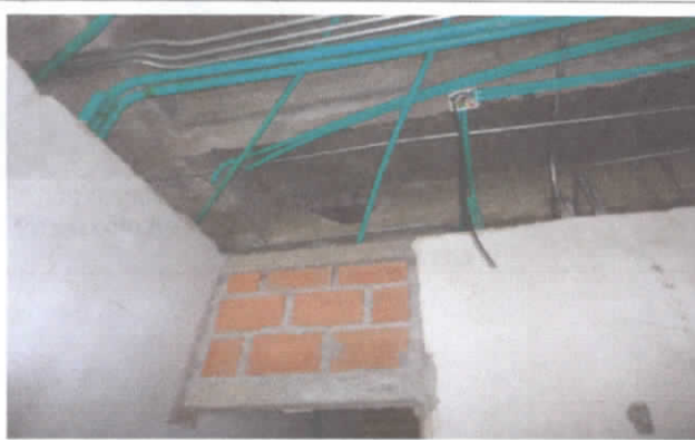
10. Esfuerzos cortantes inducidos sobre un dintel en deficientes condiciones constructivas
