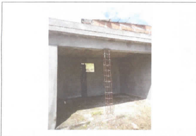
12. Proyección de columna, sin las mínimas condiciones constructivas pertinentes
