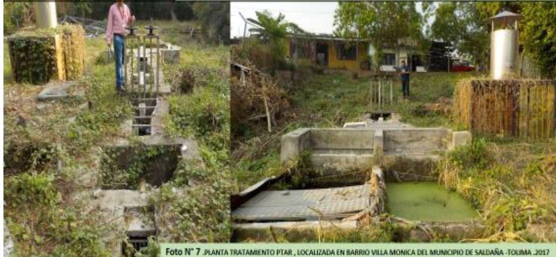
Foto N° 7 .PLANTA TRATAMIENTO PTAR , LOCALIZADA EN BARRIO VILLA MONICA DEL MUNICIPIO DE SALDAÑA -TOLIMA .2017
