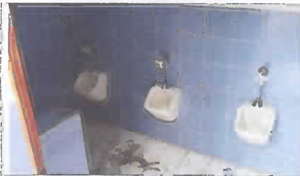
19. Mas aparatos sanitarios en buen estado
