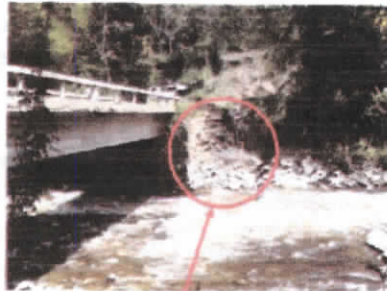
Socavación lateral de la margen izquierda, por la pérdida total de la aleta de protección.
