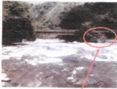
Zona de la vía afectada por socavación lateral.
